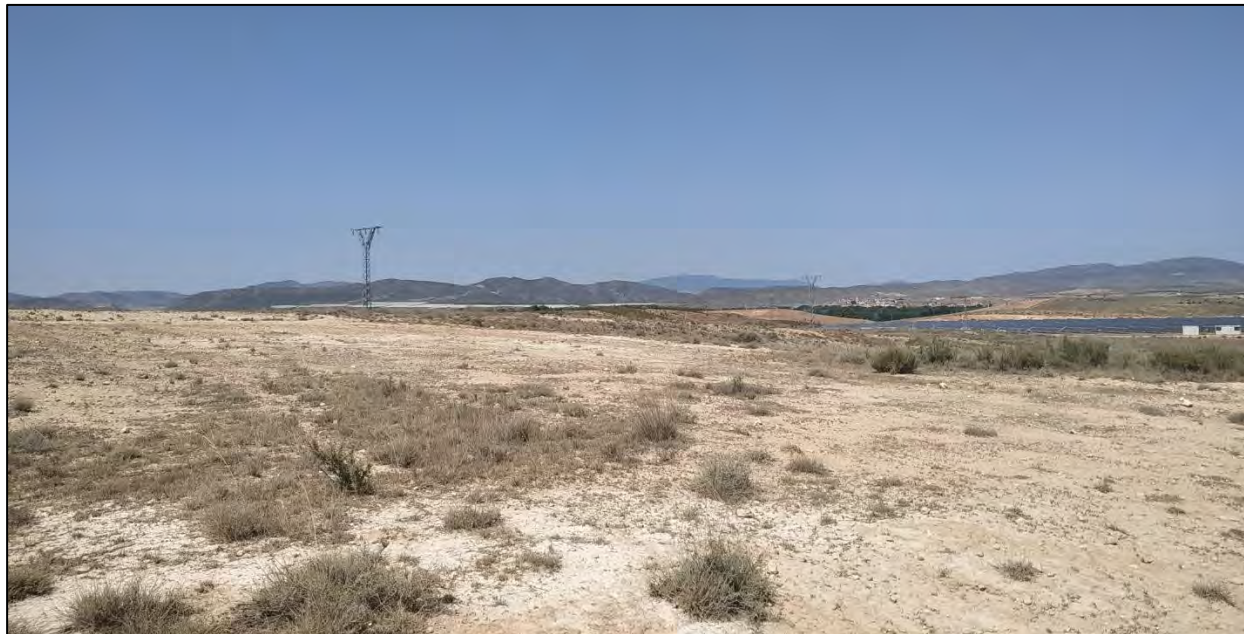
Fotografía 14: Vista de la línea eléctrica de evacuación de la planta fotovoltaica contigua al Sector SUZ-ND-05.1.
