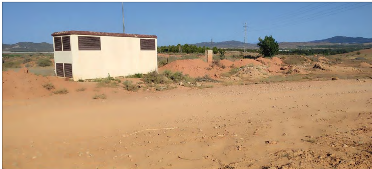
Fotografía 16: Centro de transformación existente en el Polígono La Cuesta III que servirá de conexión al Sector SUZ-ND-05.1.
