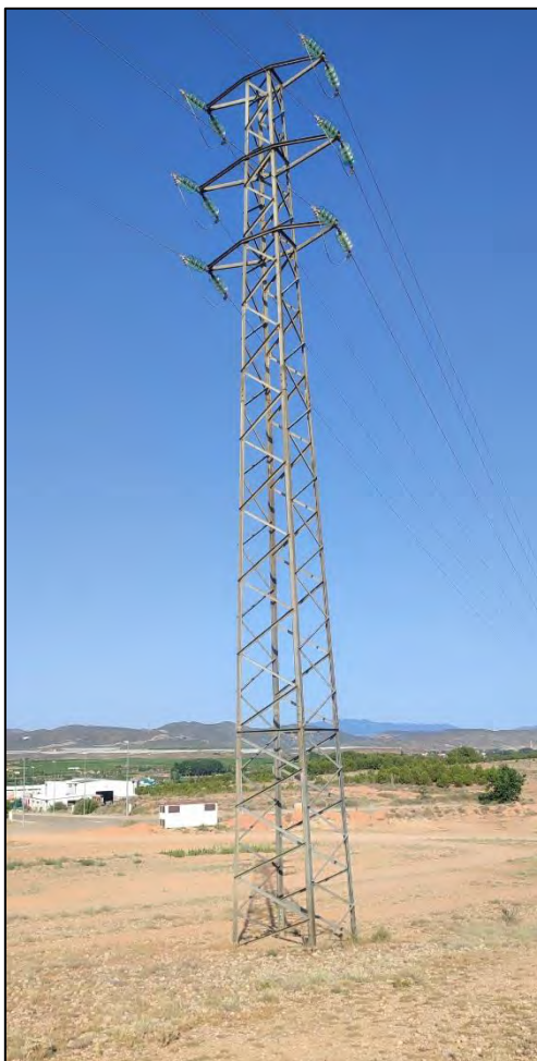
Fotografía 6: Apoyo de la línea eléctrica de alta tensión que discurre por la zona de aparcamiento del sector.
